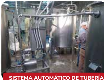
SISTEMA AUTOMÁTICO DE TUBERÍA
