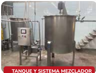
TANQUE Y SISTEMA MEZCLADOR
