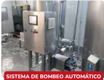
SISTEMA DE BOMBEO AUTOMÁTICO
